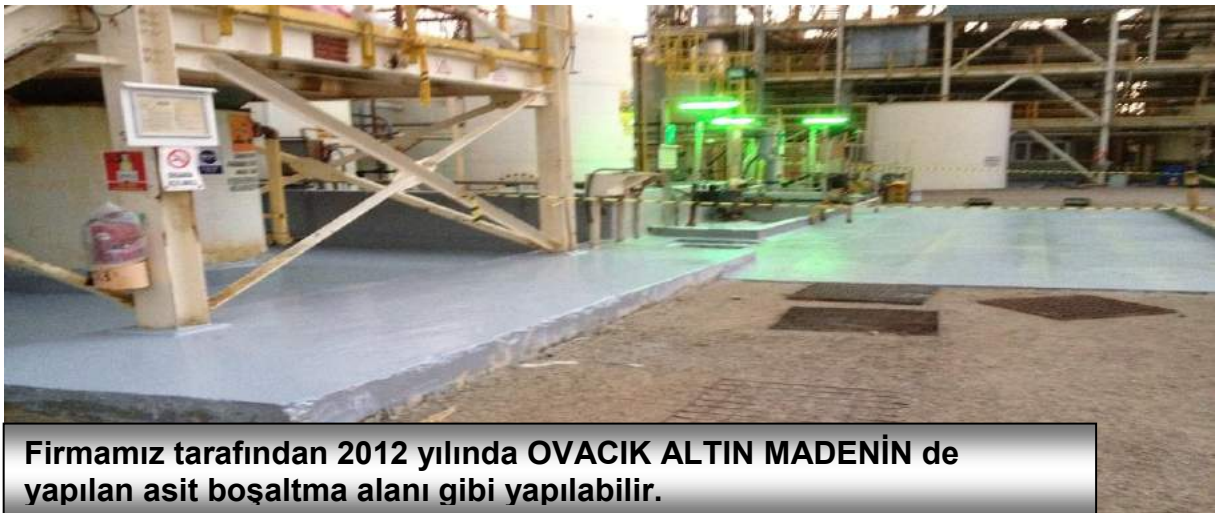
Firmamız tarafından 2012 yılında OVACIK ALTIN MADENİN de yapılan asit demirüçklörür havuzu gibi yapılabilir.
