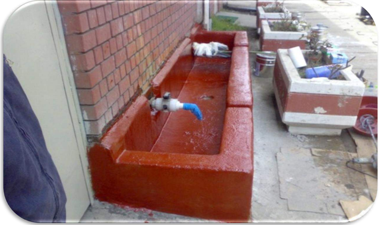
ENVIRO PROTECT 1354 MR ile kaplanmış acids loading area
