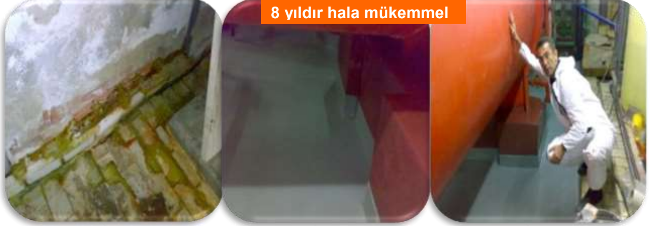
Asit kaçakları bina kolonlarını ve zeminleri eritiyor
