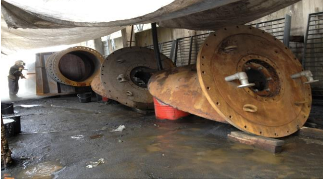
Deniz suyu sirkilasyon pompası aşınmış hali
