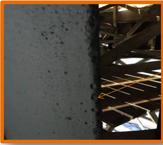
Kanatların deforme hali
